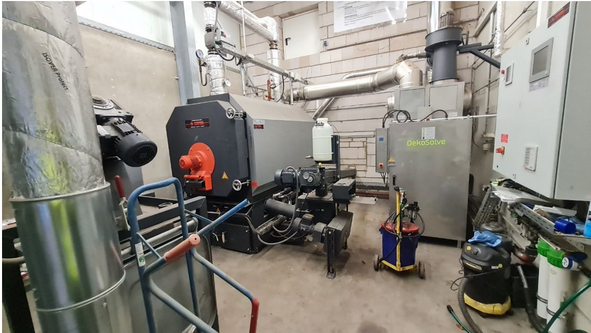
Bild: Hackschnitzelheizung am AWZ Niederzissen
